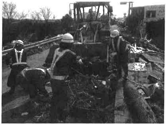
東日本大震災で青森県八戸市のがれき撤去の作業をする地域建設業者（2011年3月14日）（米田雅子・地方建設記者の会編著『大震災からの復旧—知られざる地域建設業の闘い』（ぎょうせい）より）
