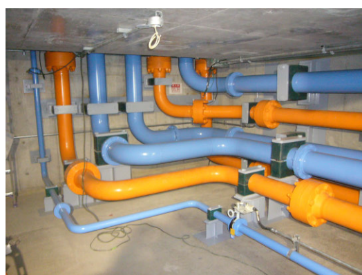
05 高圧・低圧配管
