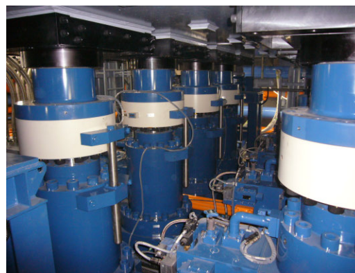
06 鉛直動的ジャッキ
